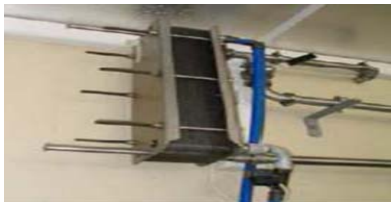
Fig.3.11 Vue d'un échangeur à plaques
