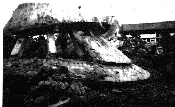
Figure 2.6: Effondrement total réservoir d'eau surélevé 1500 m 3 à Rasht.
