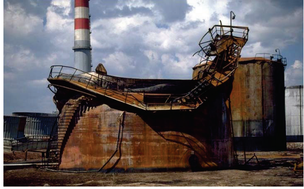
Figure 2.3: Dommages causés par le feu à des réservoirs de naphta à la raffinerie de Tüpras.
