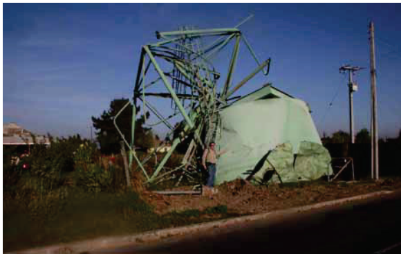
Figure 2.5: Réservoir en acier surélevé typique affaissé au Chili (construit en 1999)
