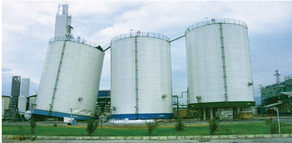
Figure 2.4: Deux réservoirs d'oxygène liquéfié endommagés (LOXT) et le réservoir en bon état liquéfié d'azote (LNT, à droite) à l'installation Habas. (Sezen et al., 2000)
