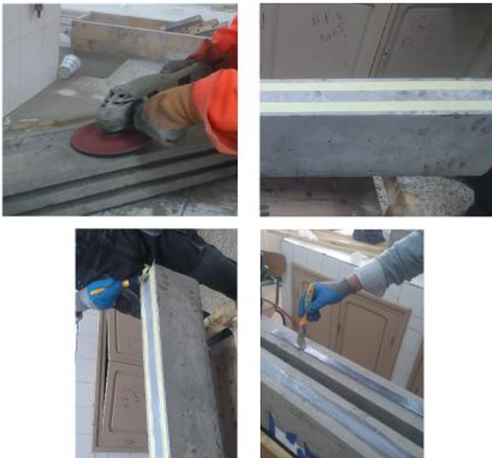
Figure A. 2. Préparation de surface, traçage et application de la résine pour le renforcement selon EBR.
