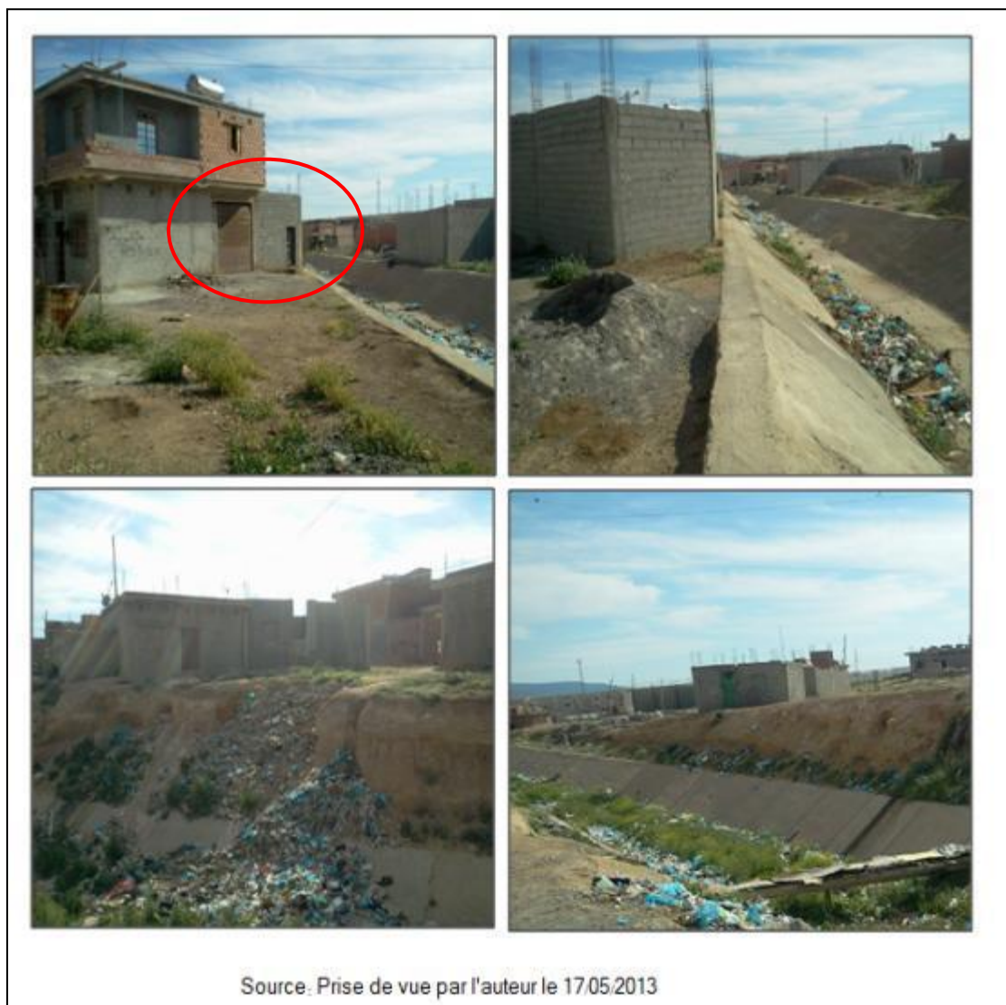
Photo VII-18 : L'un des deux Oueds traversant le quartier de Ouled B'china Une construction individuelle où sa limite s'arrête avec la limite de l'Oued, nous voyons bien que la porte d'entrée et le garage sont à proximité du petit lit de l'oued, devenu un dépotoir pour les décharges
