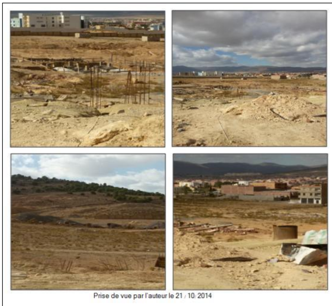
Photo VII-28 : Le site devant accueillir le lycée est empiété par des fondations en cours de réalisation d'une promotion immobilière privée
