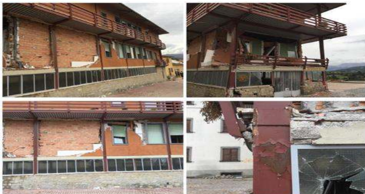
Figure 6.2. Dommages relevés sur le cas des bâtiment étudiés après la séquence de séisme de 2016-2017 (dommages significatifs sur les remplissages et écrasement aux connexions poutre-poteau).
