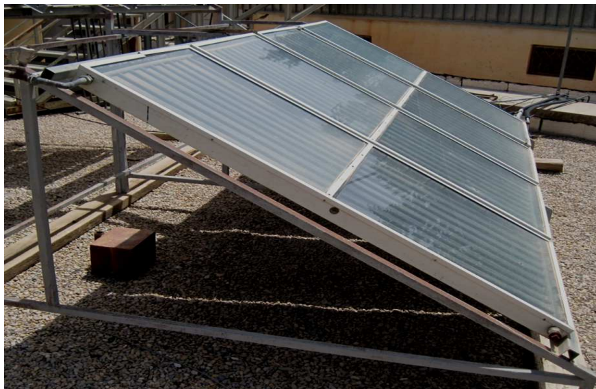
Fig.5.3 : Vue du champ de capteurs plans solaires installés sur la terrasse du laboratoire d'énergie solaire.
