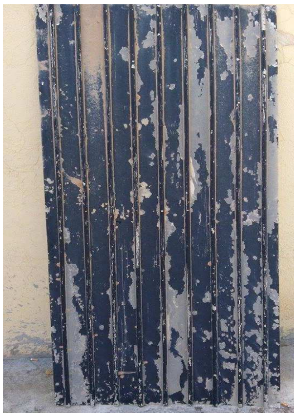
Figure. B-3 : L'absorbeur (en état de dégradation après une longue période de son exposition au soleil).
