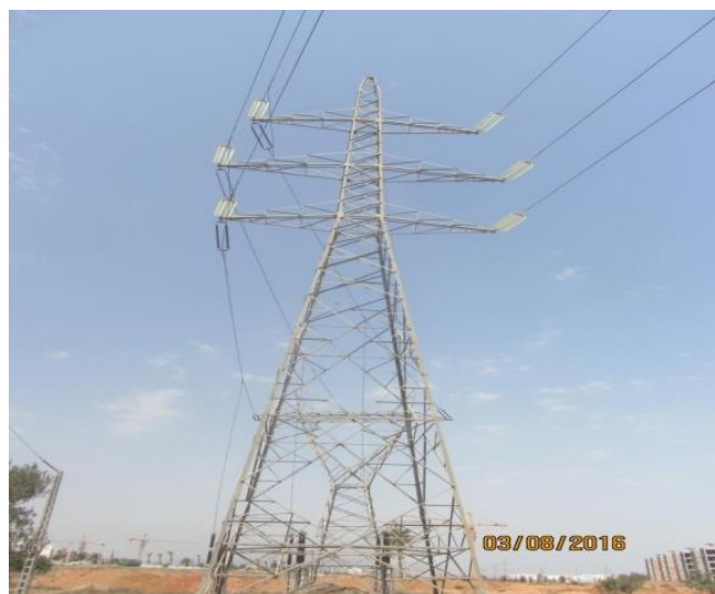
Figure V.9 Ligne 60 kV PETIT LAC – TRAMWAY
