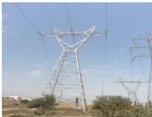
Figure V.7 Ligne 60 kV HASSI AMEUR – PETIT LAC
