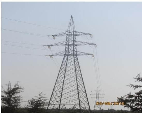
Figure V.16 Ligne 220 kV HASSI AMEUR – PETIT LAC un seul conducteur par phase
