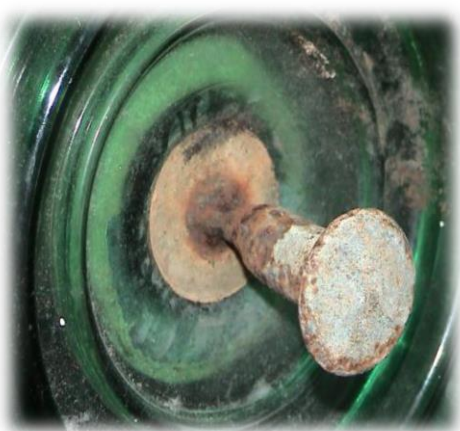
Corrosion d'un isolant
