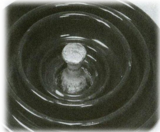
Fissure dans le ciment d'une Porcelaine
