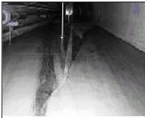
Figure II.9 : soulèvement puis dislocation du radier d'un tunnel (A, robert et D, Fabre).
