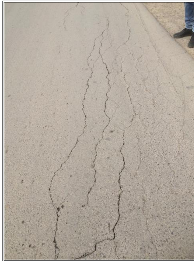
Figure III.6 : Dommage de gonflement dans la région d'Oum-Elbouaghi
