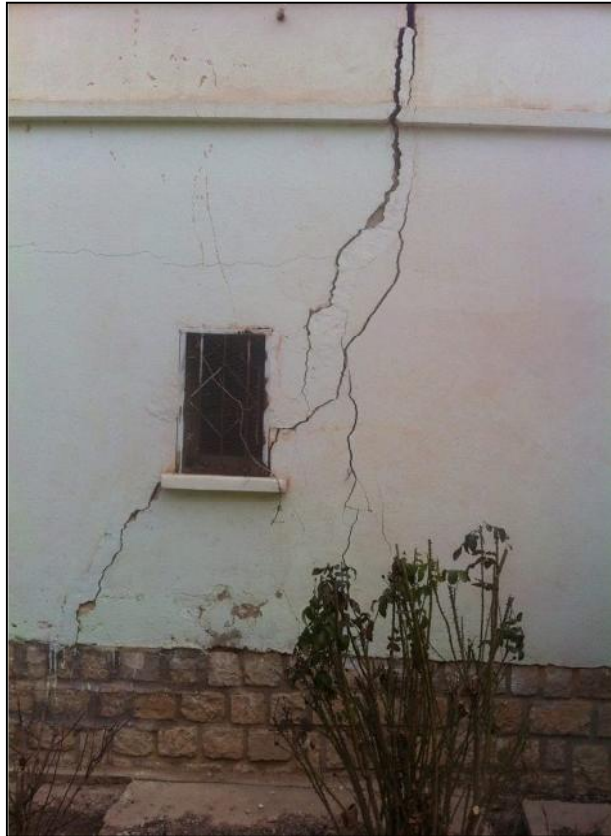
Figure III.2 : Dommages de gonflement dans la région de Bitam
