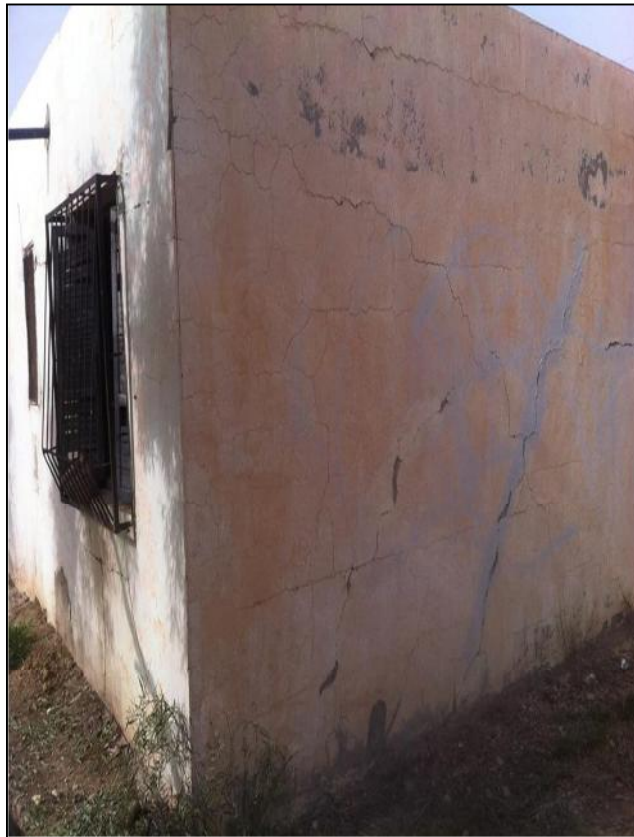
Figure III.5 : Dommages de gonflement dans la région de Méskiana
