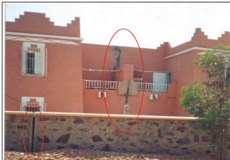
Figure II. 4 : Dommages structuraux dus au soulèvement de terrain au Maroc
