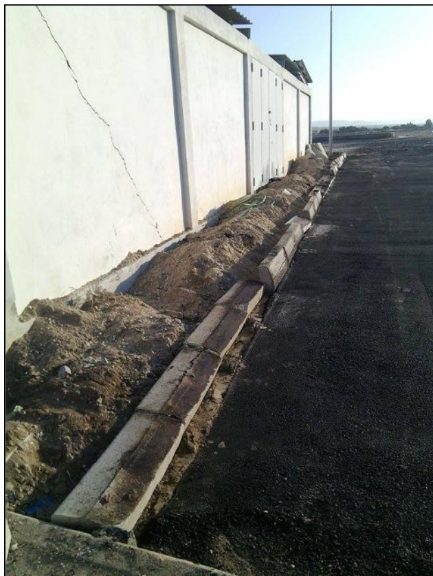
Figure III.3 : Dommages de gonflement dans la région de Tébessa
