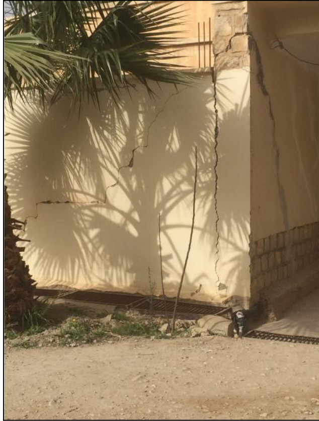
Figure III.4 : Dommages de gonflement dans la région de Timgad
