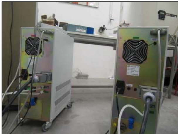
Les échangeurs de chaleur
