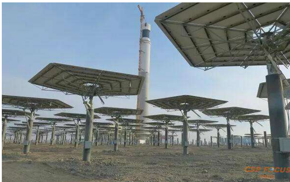
Figure.1.6. Centrale solaire Hami 50Mw CSP Project [23].
