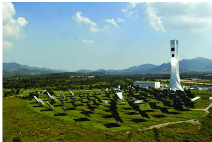
Figure 1.12. Centrale solaire à tour Dahan.
