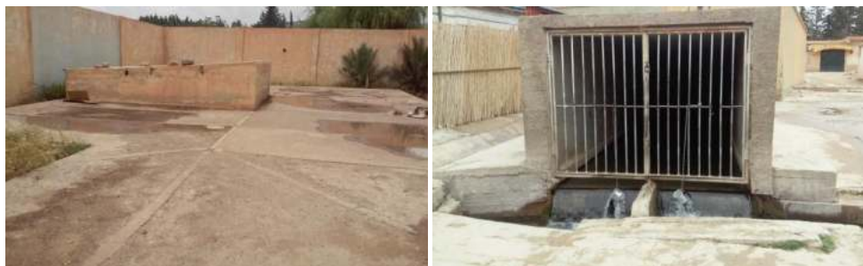
Figure 55: chambre de captage et répartiteur des eaux de la source.
