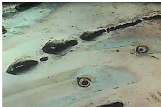
Fig. V.50(b). Alignement des piqures d'un échantillon traité, polarisé dans 02 nmole/g H 2 O 2 , T 37°C (X50)
