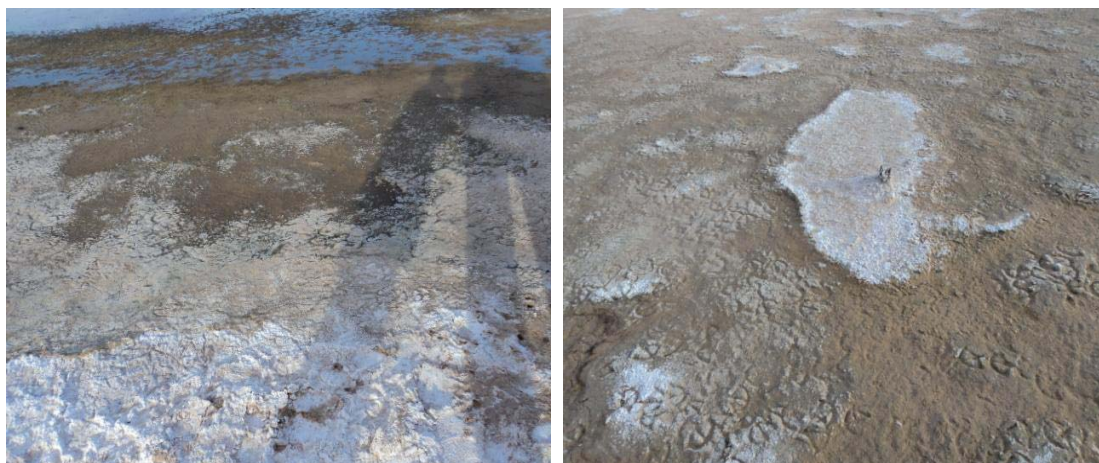
Figure 2.2 phénomène de remontée de la nappe avec les traces gypso-salifère.
