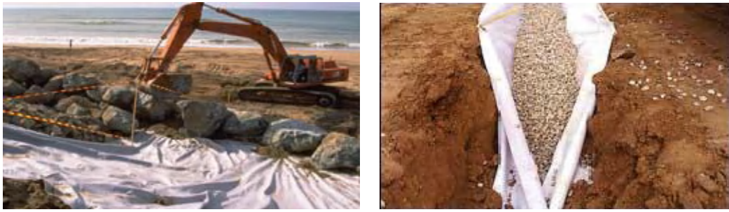
Figure 1-9 : Utilisation pour filtration.
