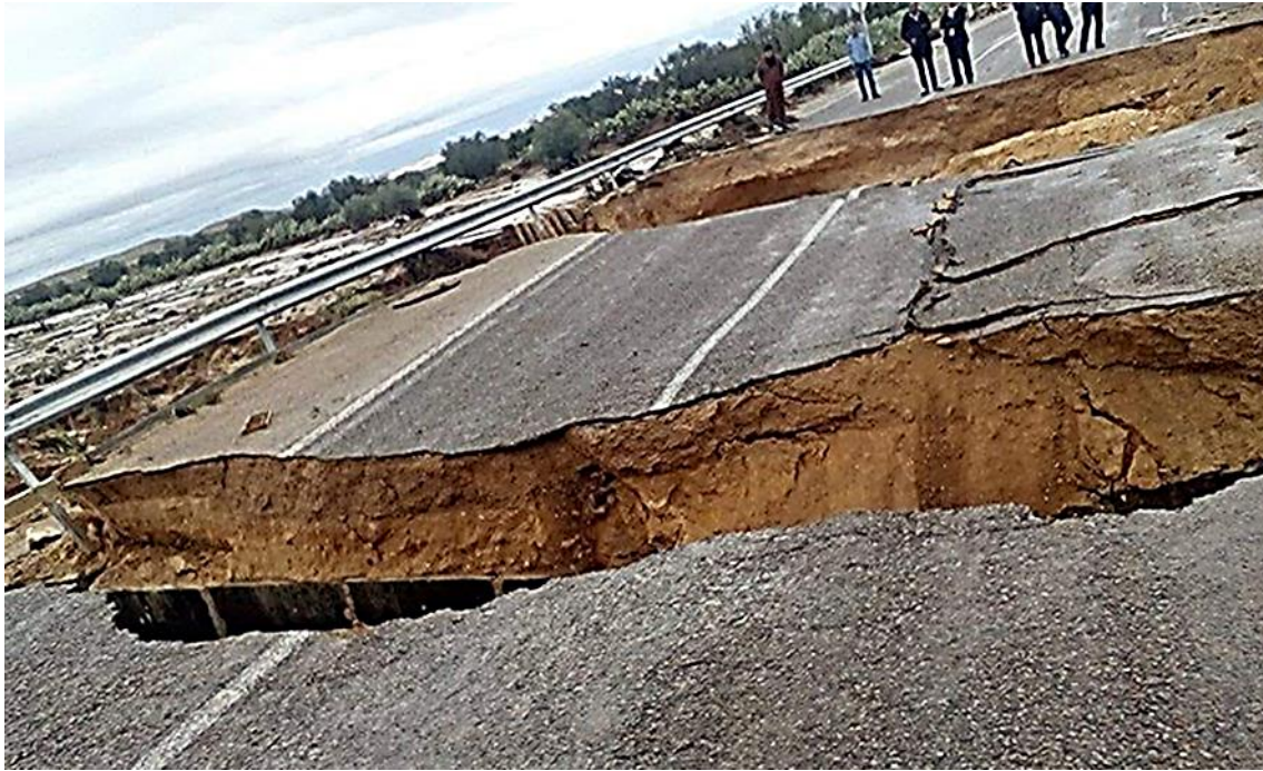
Photo. II. 2. Effondrement du pont de Sidi- Salem à Mascara en 2012.
