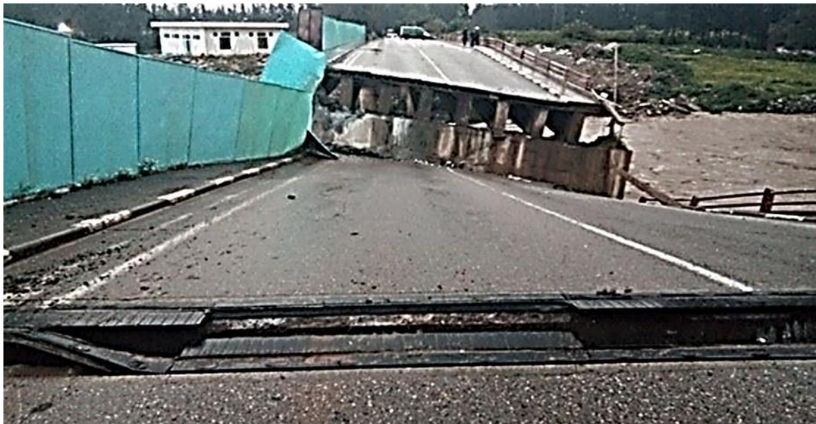
Photo. II. 1. Effondrement d'un pont sur l'axe Médéa-chiffa en 2018.
