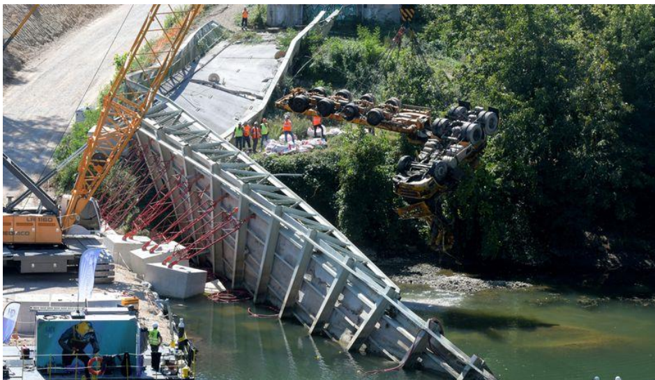
Photo.I.2. L'effondrement du pont de Mirepoix-sur-Tarn, en Haute-Garonne en 2019
