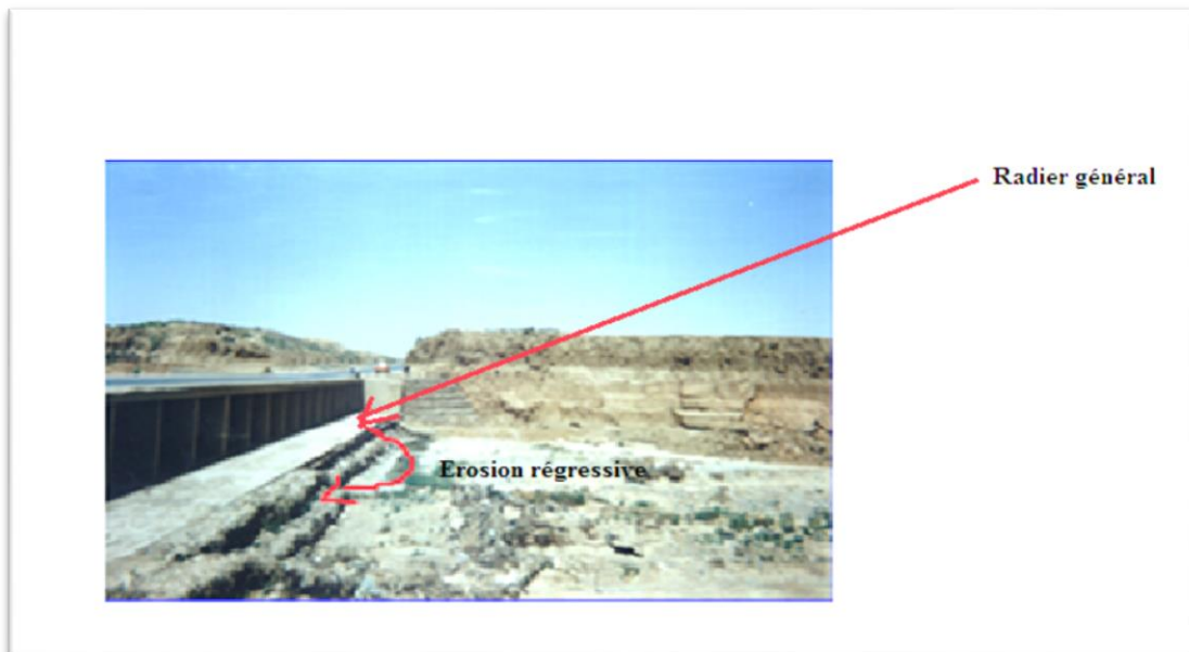
Photo. II. 13. Erosion régressive, cas du pont cadre sur la RN28.
