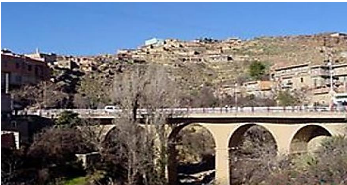
Photo. II. 4. Risque d'effondrement d'une partie du pont principal, Arris, Wilaya de Batna.
