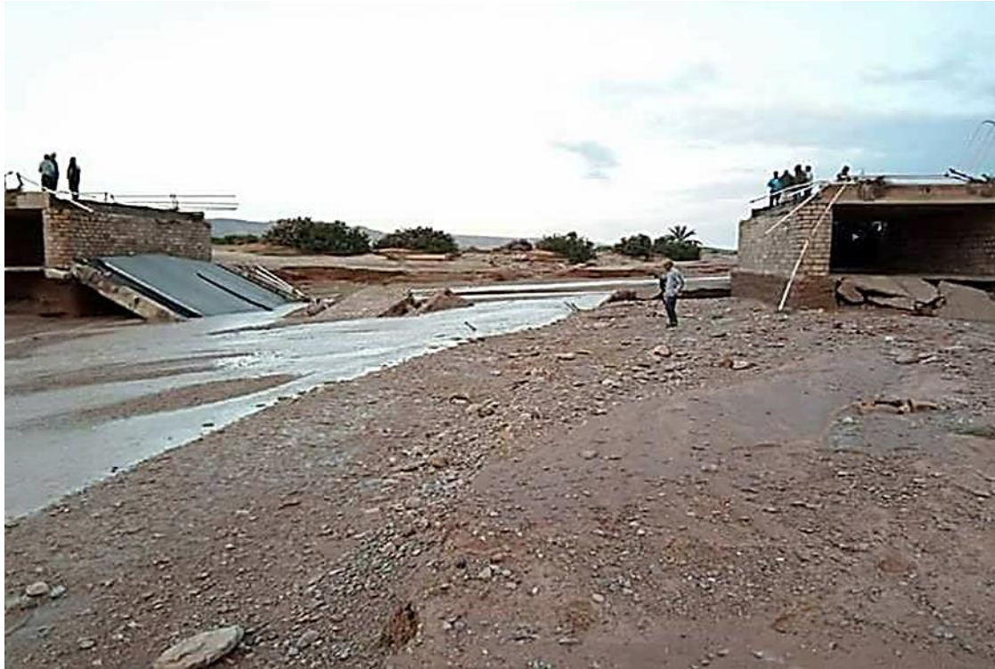
Photo. II. 3. Effondrement partiel du pont d'Oued Bourdim (Wilaya de M'sila) sur la RN8 en 2018.
