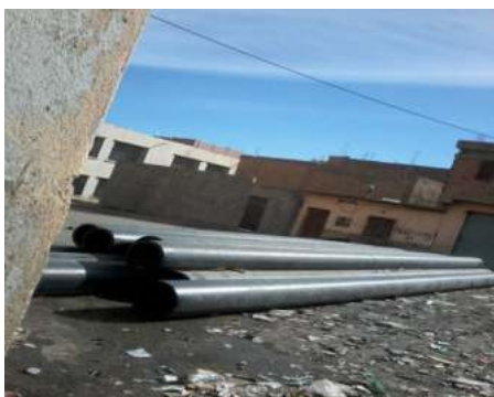
Photo N° 07 : Conduites en PEHD
