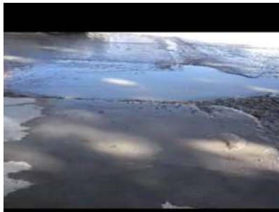
Photo. 08 : Fuite d'eau à Z'mala (2015)
