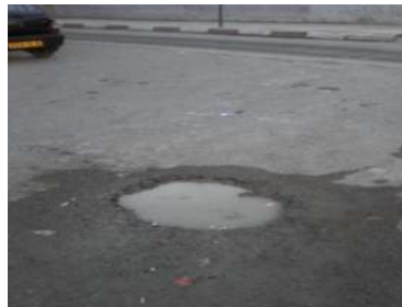
Photo. 09 : Cassure de la conduite (Bouakal2015)
