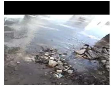
Photo. N°10: Fuite d'eau au centre ville (2016)
