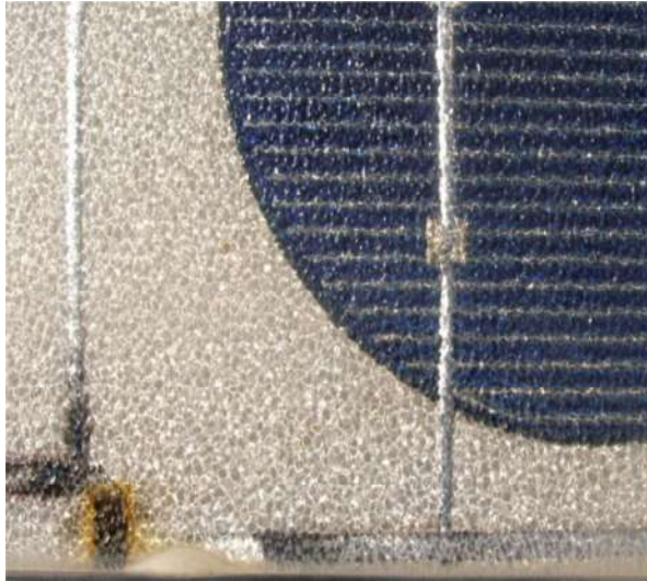
Figure III.19 Création des points chauds sur les connexions (+ et -) des modules PV.
