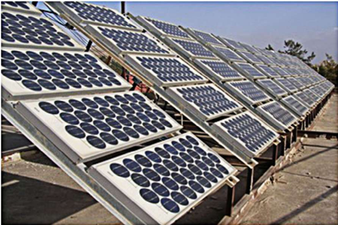
Figure III.10 Vue du générateur photovoltaïque de 2.4\text{kWp} , installé sur la toiture du centre Abrouk Madani, université Batna 2.
