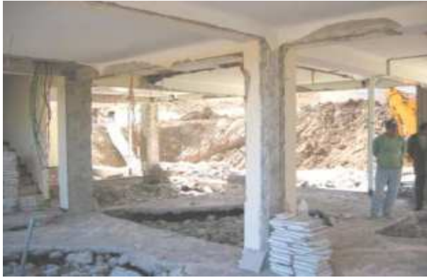
Fac-similé V.2: Conséquences du tassement au niveau du rez de chaussé
