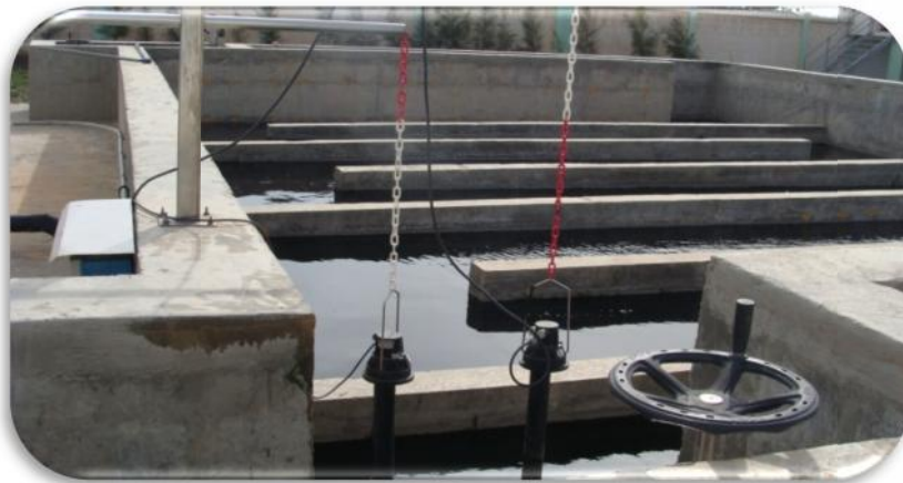
Figure.III.7. Photo Représentant l'Ouvrage de Désinfection.
