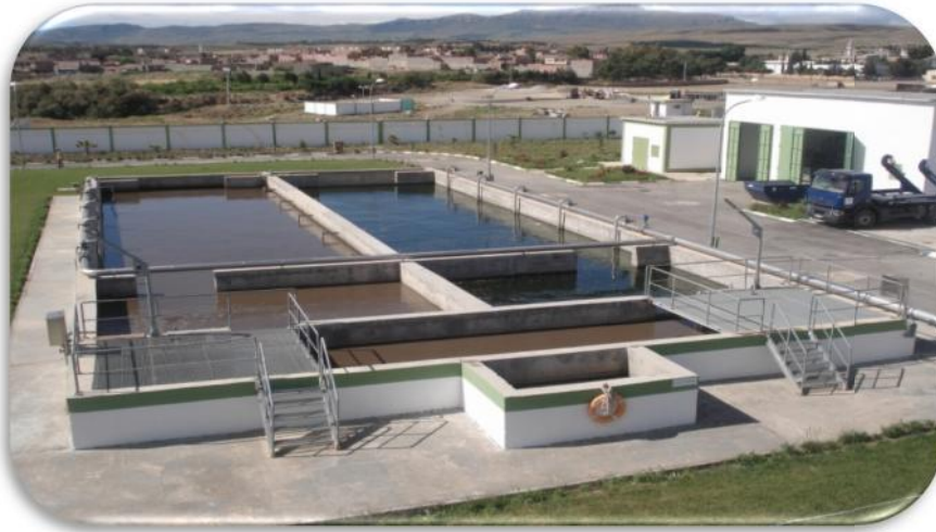
Figure.III.5. Photos Représentant l'Ouvrage du Bassin Biologique.
