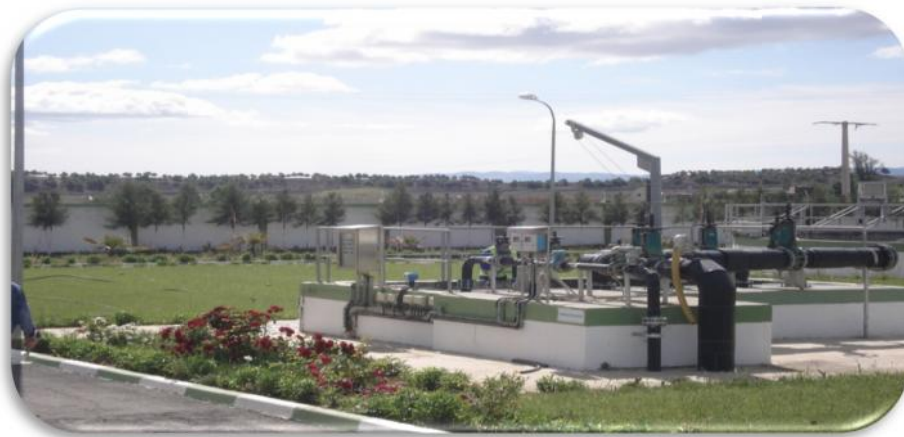
Figure.III.8. Photo Représentant l'Ouvrage du Pompage des Boues.
