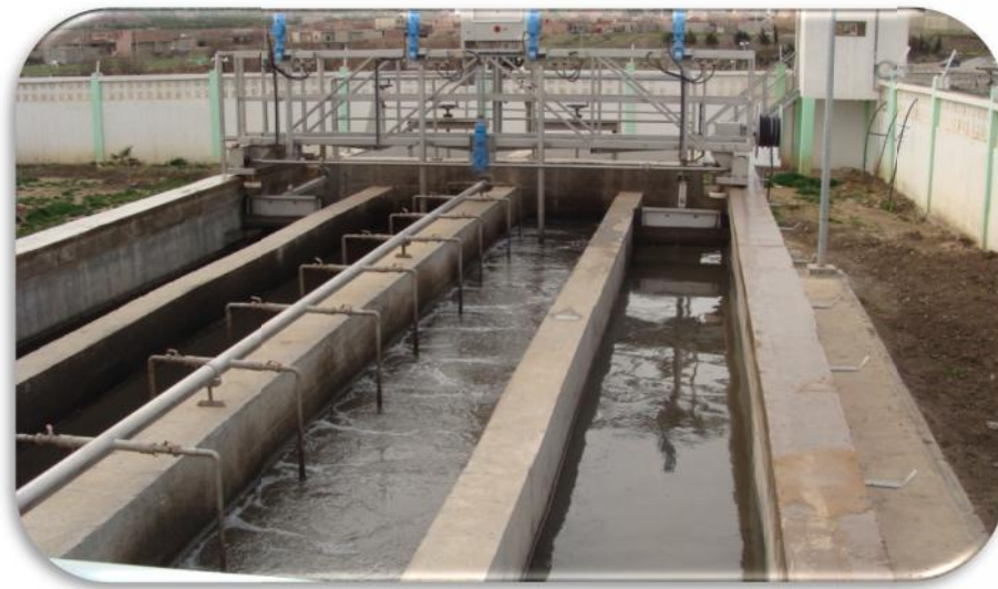
Figure.III.4. Photos représentant l'Etape du Dessablage et Déshuilage de l'Ouvrage Prétraitement.
