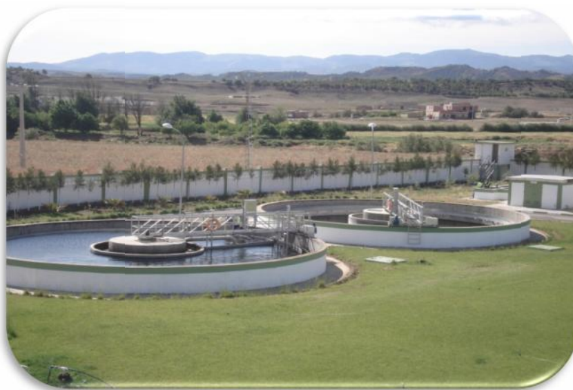
Figure.III.6. Photo Représentant l'Ouvrage de la Clarification.
