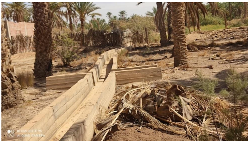
Figure 43. Destruction des seguias avec la construction des techniques modernes qui interdit l'accès des eaux aux palmiers Oumache
