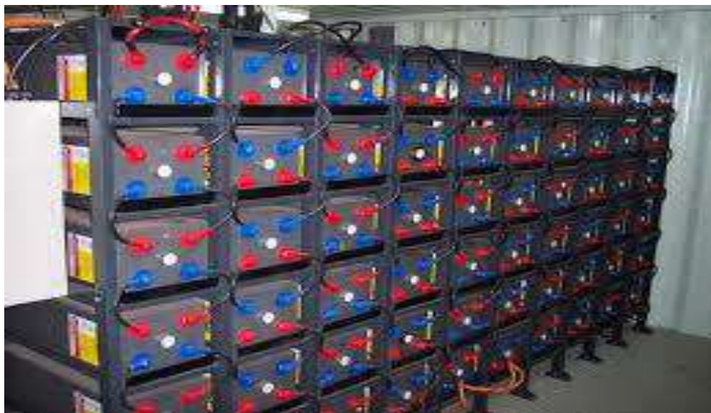
Fig. (II.26) Pack de batteries pour système solaire [29]
